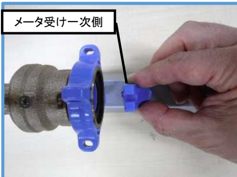
メータ受け一次側 差込み
